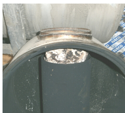
I depositi di urea bianca cristallina ostruiscono lo scarico
